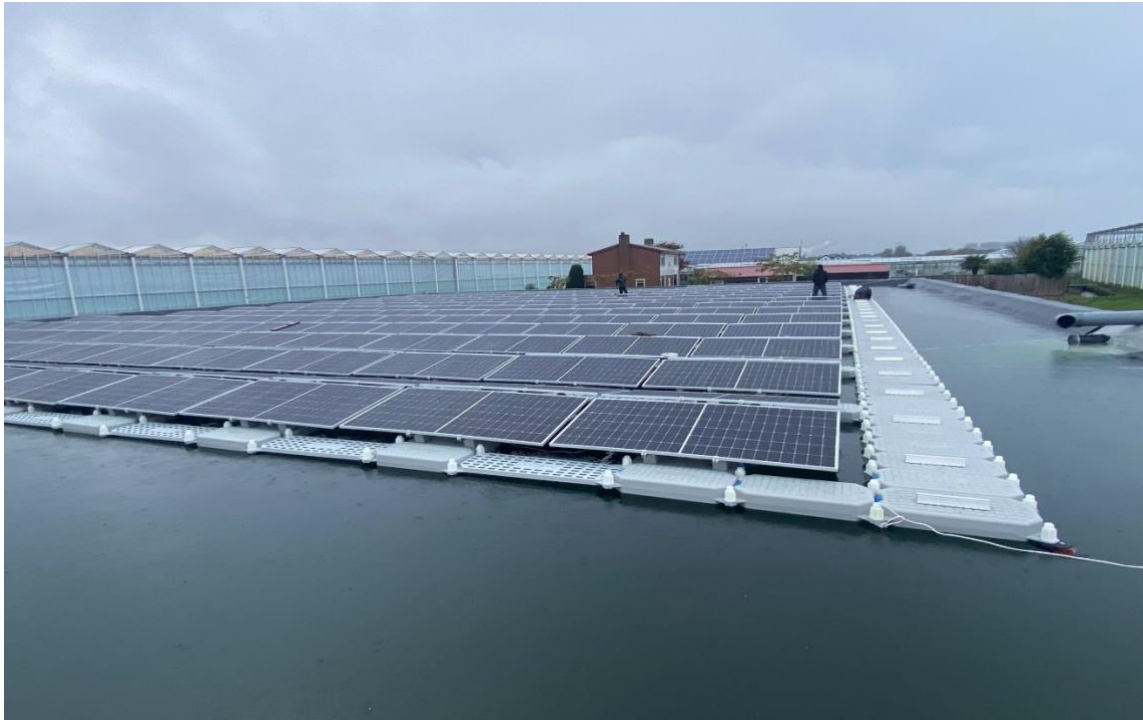
Figuur 4. Zonnepanelen op waterbassin van projectlocatie 1
